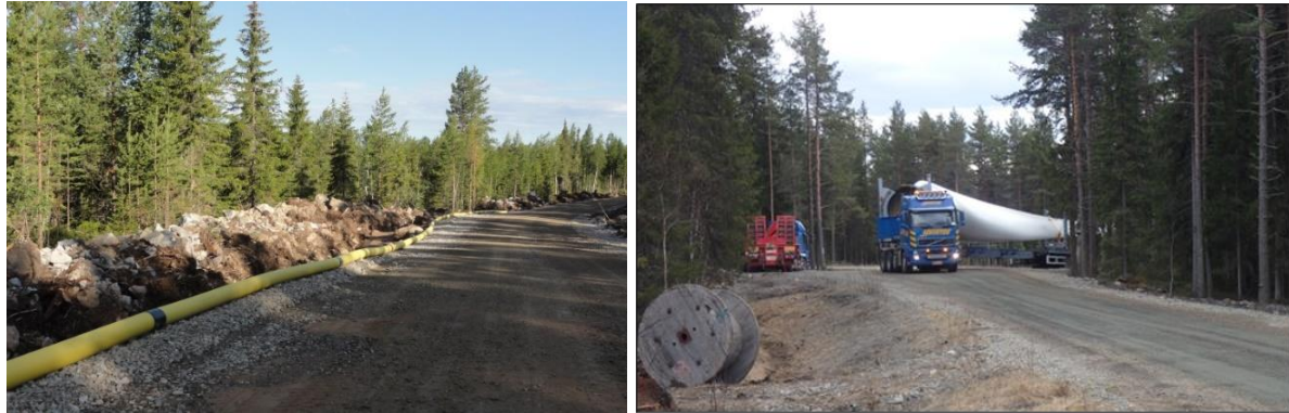
Kuva 79. (Vasemmalla) Esimerkki tuulivoimapuiston rakennus- ja huoltotiestä. Teitä käytetään muun muassa betonin, soran ja voimaloiden komponenttien kuljetuksiin sekä tuulivoimapuiston käyttövaiheessa huoltoajoihin. Maakaapeli sijoitetaan ojakaivantoon tien reuna-alueelle. (Oikealla) Tuulivoimalan osia kuljetetaan erikoiskuljetuksina. (Kuvat: Ville Suorsa / FCG).
