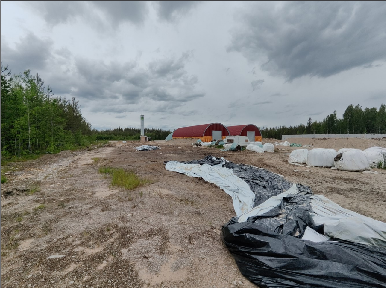
Kuva 10. Biokaasulaitoksen tontti on pääosin raivattu kasvillisuudesta paljaaksi. Alueella on rakennusten lisäksi pyöröpaaleja ja muoviroskaa
